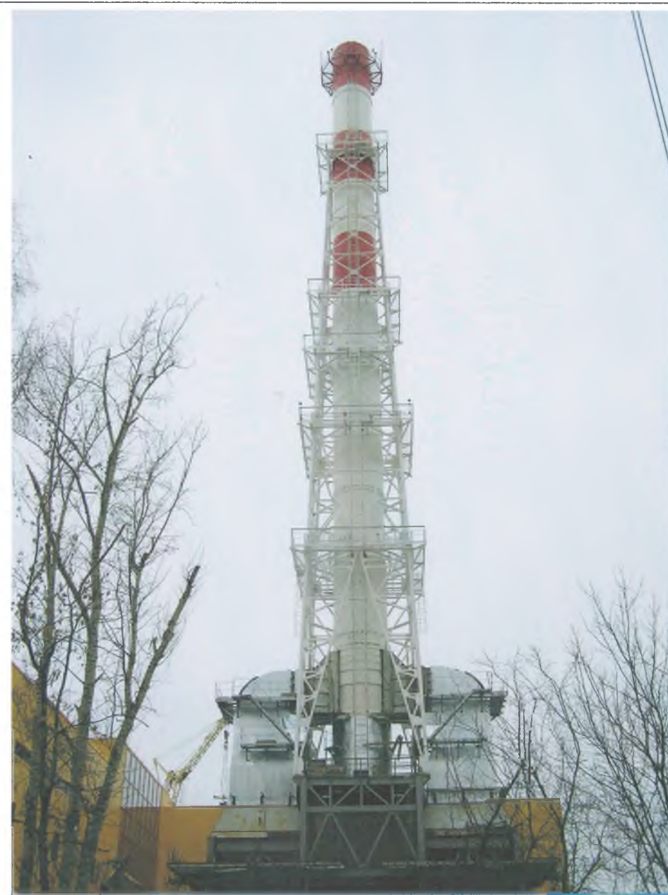
Филиал №8 «Западный» ОАО «МОЭК» г.Москва, КТС-26
