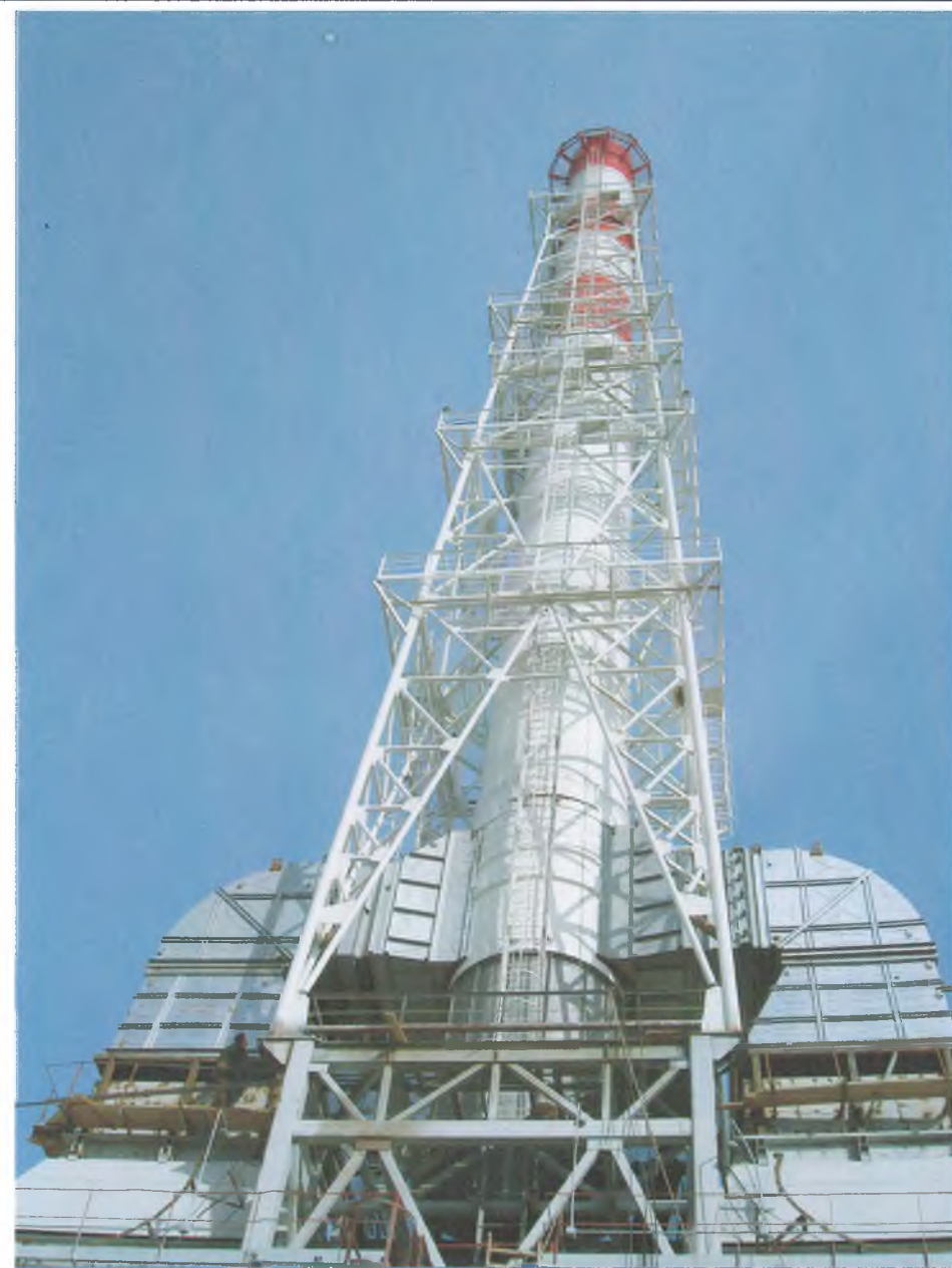
Филиал №7 «Юго-Западный» ОАО «МОЭК» г.Москва, КТС-54
