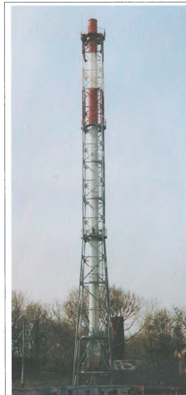
г.Москва, Котельная кв.51
