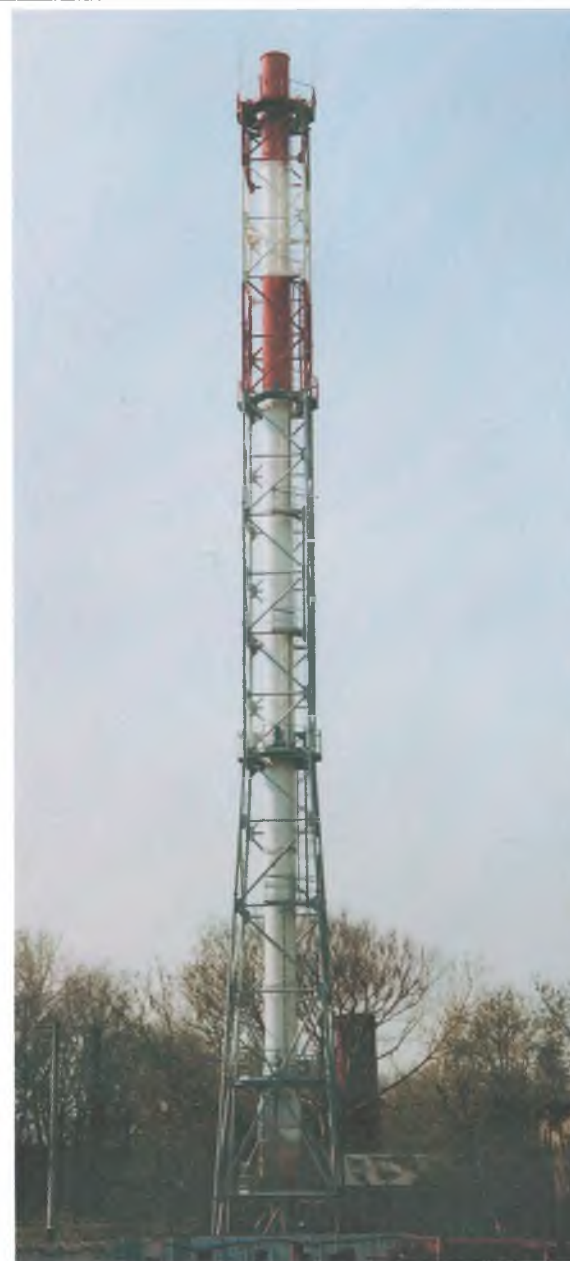
Филиал №8 «Западный» ОАО «МОЭК» г.Москва, КТС-24
