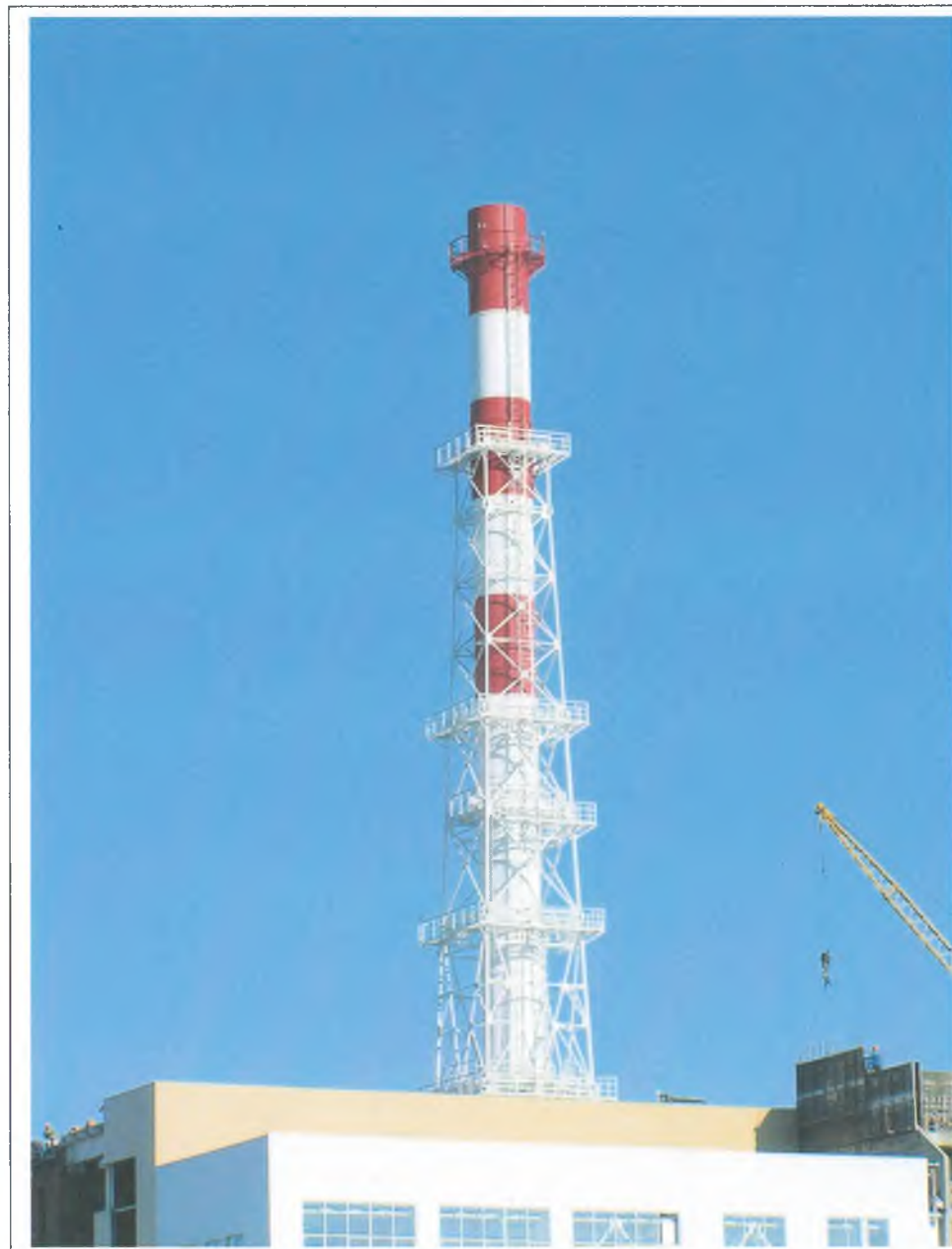
Филиал №8 «Западный» ОАО «МОЭК» г.Москва, КТС-11А
